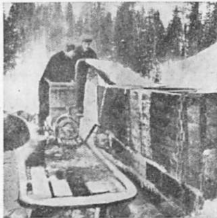
Kuva 37. — Räjähdysmoottorilla toimiva konepumppu käynnissä.
