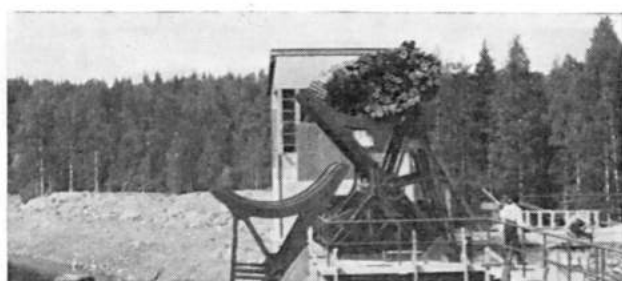
Kuva 9. Valmet Oy:n valmistamaan nippunosturiin kuuluu kaksi kuljetusvaunua, toinen yläveden ja toinen alaveden puolella. Nostovaunun saavuttua ylimpään asentoonsa se odottaa, kunnes laskuvaunu on kohonnut kuorman alle ja siirtyy vasta sen jälkeen alaspäin. Laskuvaunu kuljettaa nipun ala-altaaseen. Taustalla konekoppi.
